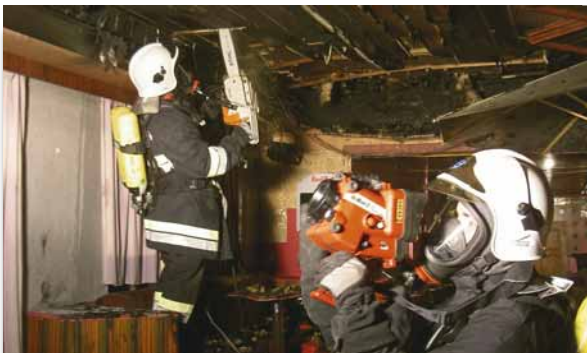
Brandesatz in der Discotheek C2 (Gasthaus Burkhart). Aufgrund eines Kabelbrandes stand die abgehängte Decke in Flammen, nach dem Ablöschen hatten sich Glutnester gebildet, welche mittels Wärmebildkamera aufgespürt wurden, 2009.
