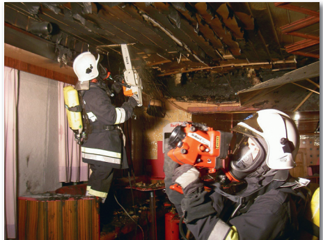
2009: Brandeinsatz in der Discothek C2 (Gasthaus Burkhart). Aufgrund eines Kabelbrandes stand die abgehängte Decke in Flammen, nach dem Ablöschen hatten sich Glutnester gebildet, welche mittels Wärmebildkamera aufgespürt wurden.
