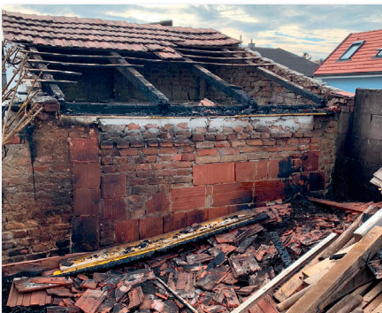
2021: Brand eines Nebengebäudes inmitten einer Wohnsiedlung. Durch den raschen Einsatz konnte ein Übergreifen auf Nachbargebäude verhindert werden.
